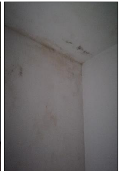
presenza di muffe in una camera
